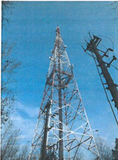
Widok obiektu wraz z zainstalowanym zespołem antenowym
