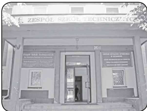
Budynek Zespołu Szkół Technicznych wymaga pilnej modernizacji
