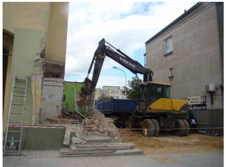
Rozbiórka przybudówki, dobudowanej do Polonii odbyła się w połowie maja. Teren po niej zostanie zagospodarowany i unowocześniony
