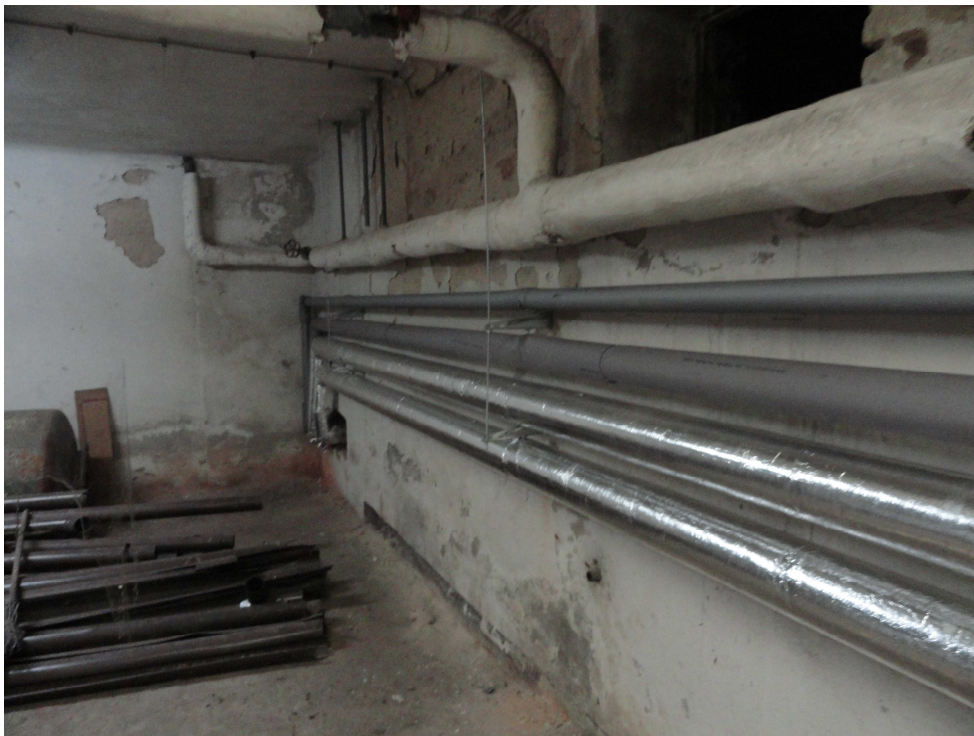
Nieczynna kotłownia - rury centralnego ogrzewania i ciepłej wody.
