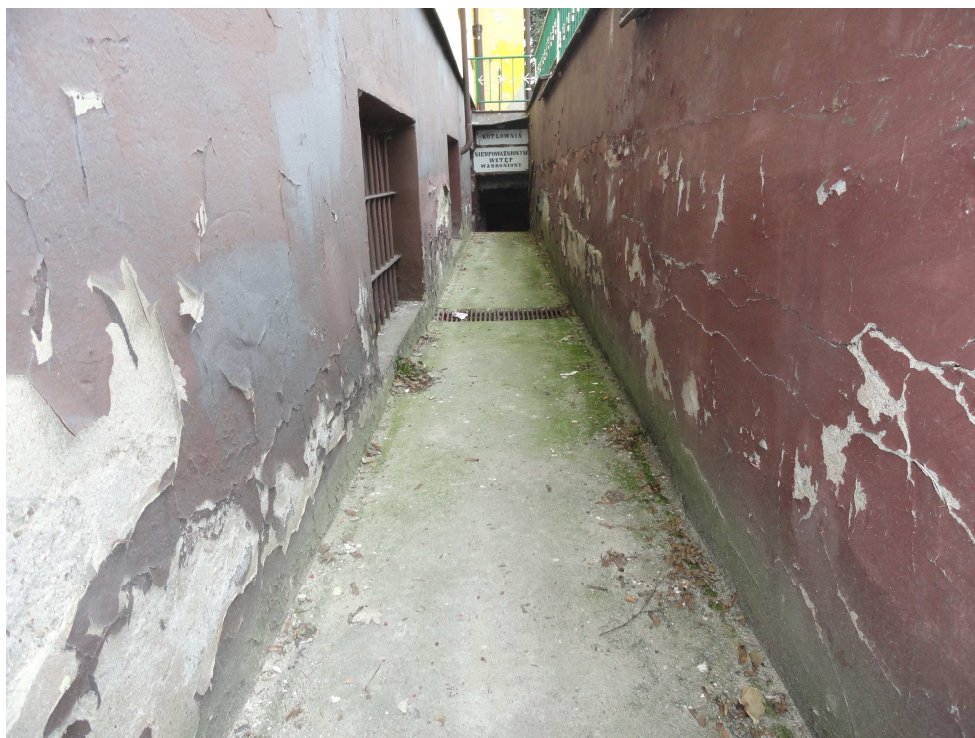
Wejście do kotłowni - uszkodzone tynki ściany zewnętrznej
