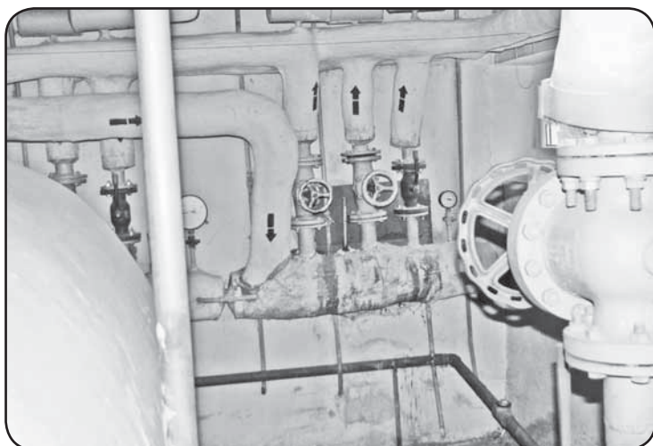
Przestarzała instalacja c.o wymagała pilnej modernizacji
