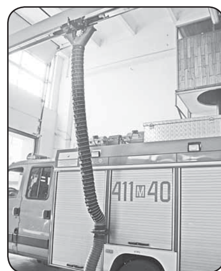
Nowoczesne rury wentylacyjne zabezpieczą wszystkie samochody ratownicze
