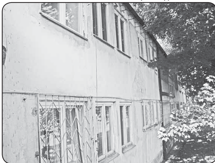
Elewacja tylnej części budynku wymagała pilnej naprawy, nadal trwają tam prace modernizacyjne
