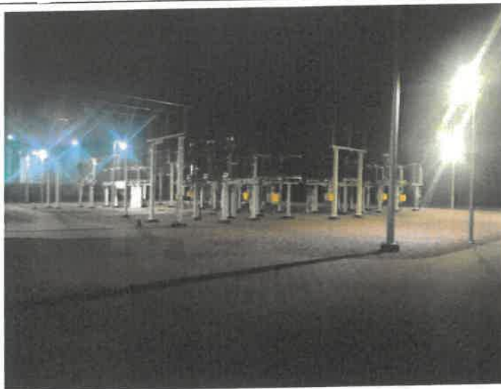
Zof. nr 1: Widok ogólny instalacji elektroenergetycznej.
